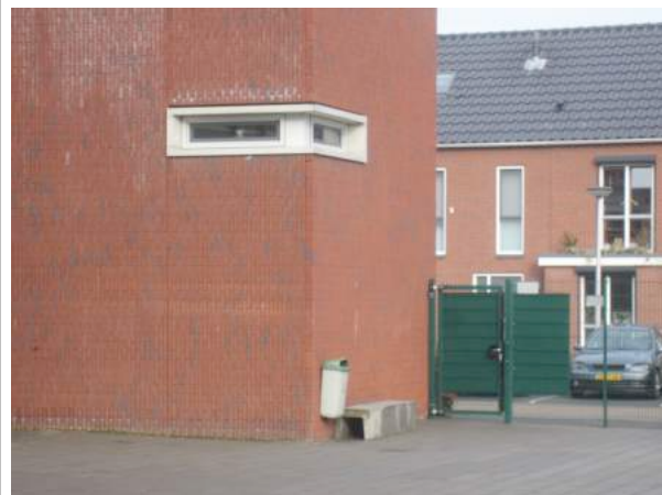
Afvalbakken tegen de gevel. Verwijderen of plaatsen op 5 meter afstand van de gevel.
