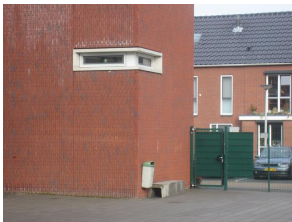
Afvalbakken tegen de gevel. Verwijderen of plaatsen op 5 meter afstand van de gevel.
